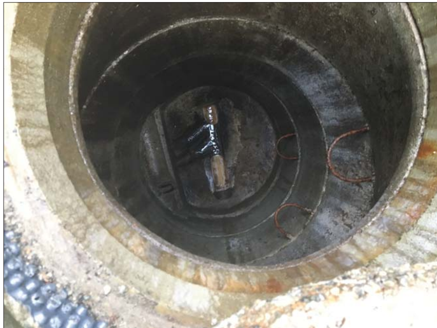
Foto: K15.JPG 0,01m, Korrosjon/Slitasje, Manglende tilslag (rørveggen er sterkt påvirket), I støpejernsrør er det kraftig rustangrep, fra 12 til 12 Kl., Start
