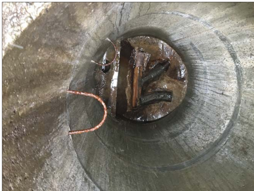
Foto: K22.JPG 0,01m, Korrosjon/Slitasje, Manglende tilslag (rørveggen er sterkt påvirket), I støpejernsrør er det kraftig rustangrep, fra 12 til 12 Kl., Start
