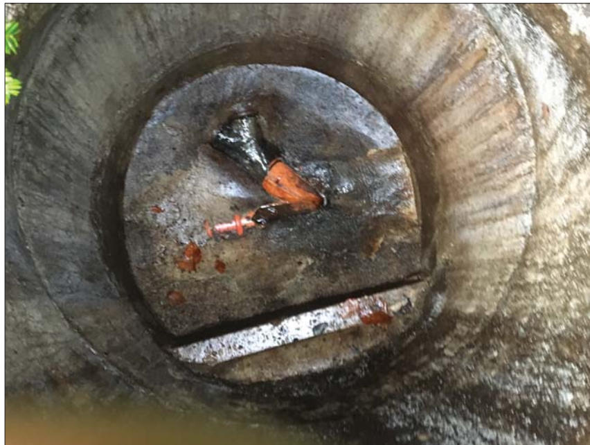
Foto: K9.JPG 0,01m, Korrosjon/Slitasje, Manglende tilslag (rørveggen er sterkt påvirket), I støpejernsrør er det kraftig rustangrep, fra 12 til 12 Kl., Start
