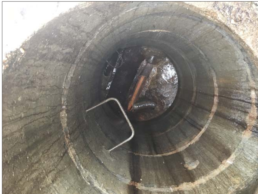
Foto: K20.JPG 0,01m, Korrosjon/Slitasje, Manglende tilslag (rørveggen er sterkt påvirket), I støpejernsrør er det kraftig rustangrep, fra 12 til 12 Kl., Start
