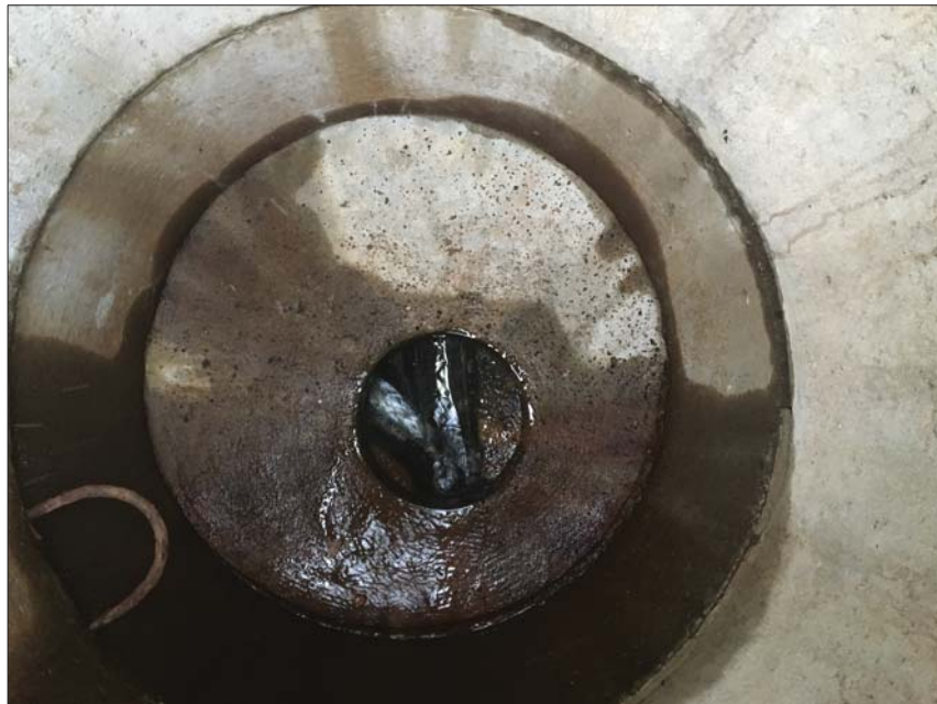
Foto: K5.JPG 0,5m, Materialendring til Støpejern
