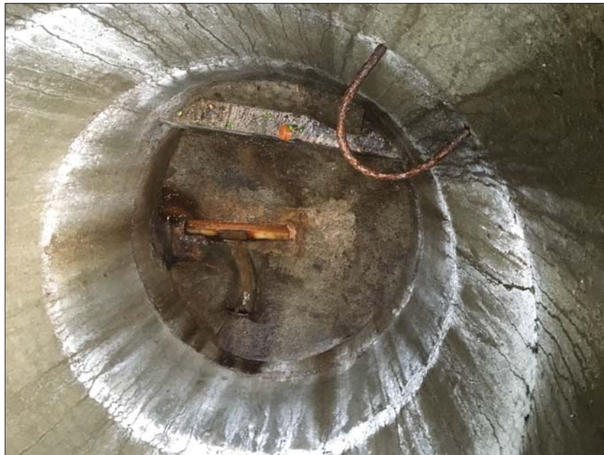
Foto: K8.JPG 0,01m, Korrosjon/Slitasje, Manglende tilslag (rørveggen er sterkt påvirket), I støpejernsrør er det kraftig rustangrep, fra 12 til 12 Kl., Start
