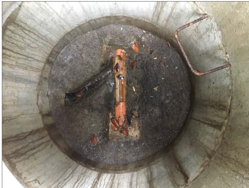
Foto: K7.JPG 0,01m, Korrosjon/Slitasje, Manglende tilslag (rørveggen er sterkt påvirket), I støpejernsrør er det kraftig rustangrep, fra 12 til 12 Kl.
