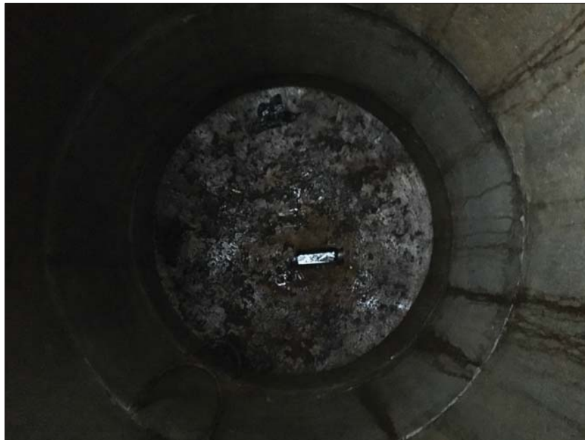
Foto: K4.JPG 0,4m, Materialendring til Støpejern
