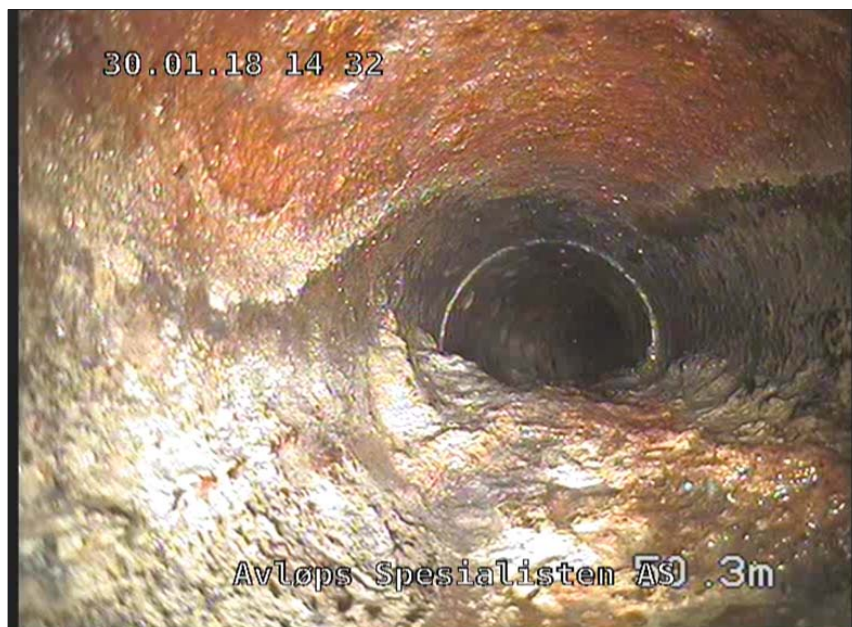
Foto: 4_1_31_02022018_153102_A.jpg 50,3m, Hindring, reduksjon i tverrsnittsareal er mellom 15-30%, 03 Kl., Utstikkende fra rørveggen, rustavleiring
