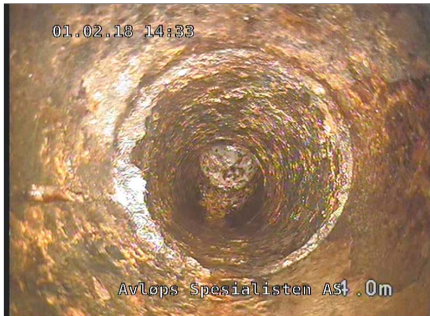
Foto: 10_1_10_05022018_135932_B.jpg 4,1m, Sprukket rør, sprekkene er åpne/løse teglstein, 09 Kl., Langsående
