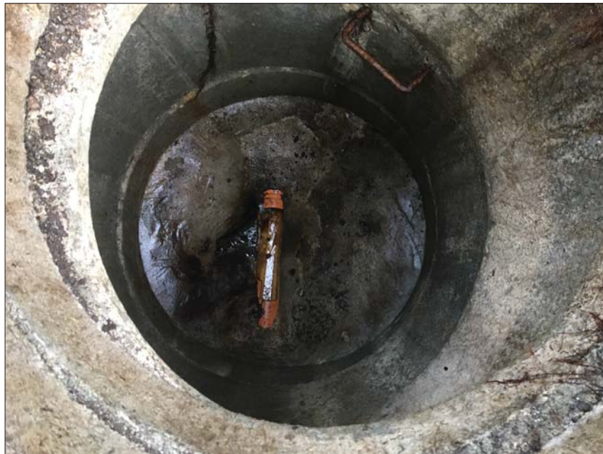
Foto: K6.JPG 0,01m, Korrosjon/Slitasje, Manglende tilslag (rørveggen er sterkt påvirket), I støpejernsrør er det kraftig rustangrep, fra 12 til 12 Kl., Start
