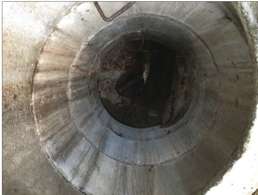
Foto: K10.JPG 0,01m, Korrosjon/Slitasje, Manglende tilslag (rørveggen er sterkt påvirket), I støpejernsrør er det kraftig rustangrep, fra 12 til 12 Kl., Start
