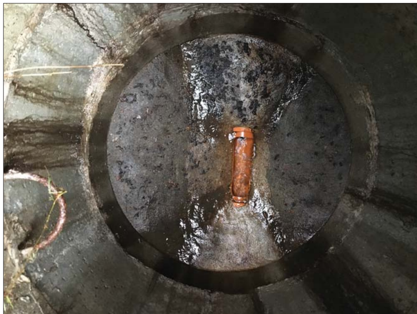
Foto: K3.JPG 0,4m, Materialendring til Støpejern
