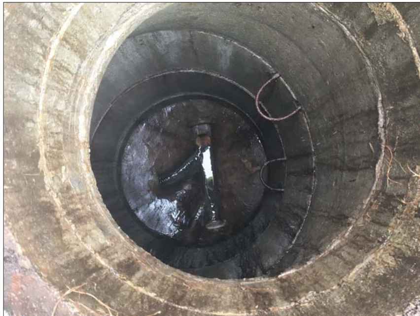
Foto: K19.JPG 0,01m, Korrosjon/Slitasje, Manglende tilslag (rørveggen er sterkt påvirket), I støpejernsrør er det kraftig rustangrep, fra 12 til 12 Kl., Start
