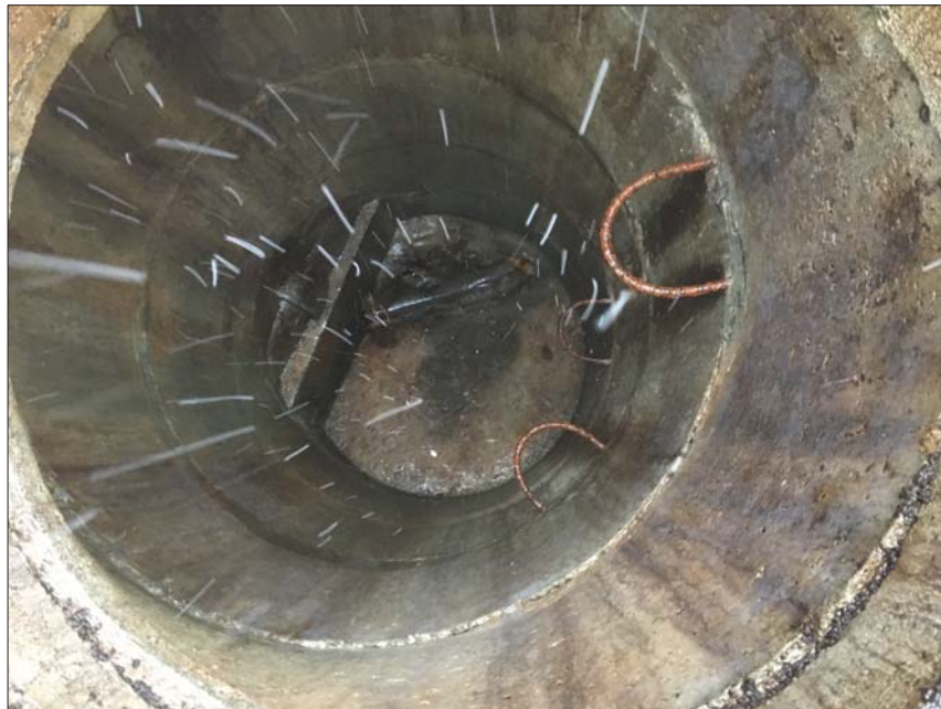
Foto: K12.JPG 0,01m, Korrosjon/Slitasje, Manglende tilslag (rørveggen er sterkt påvirket), I støpejernsrør er det kraftig rustangrep, fra 12 til 12 Kl., Start
